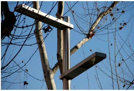
2 luminaires de hauteur différente
